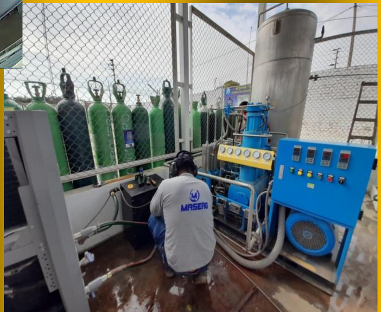
Derecha.- Soporte técnico 365 días del año (Mantenimiento de Booster de 30 m 3 /hora)
